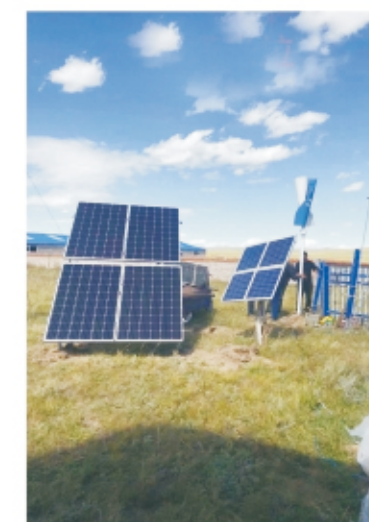
内蒙古风光互补供电系统
