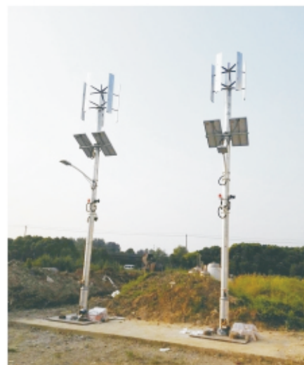
盐城大丰风光互补监控路灯一体供电系统
