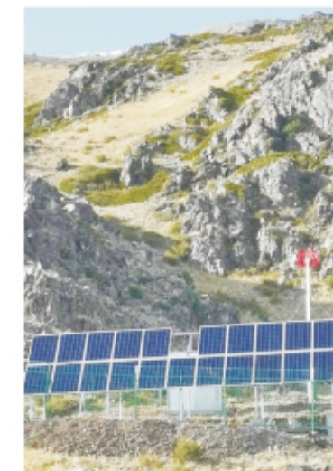
新疆供电系统风光互补供电系统
