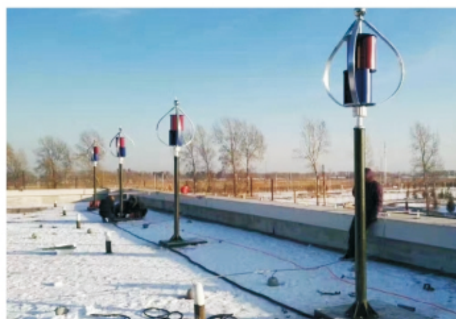
哈尔滨屋顶供电--风力发电系统
