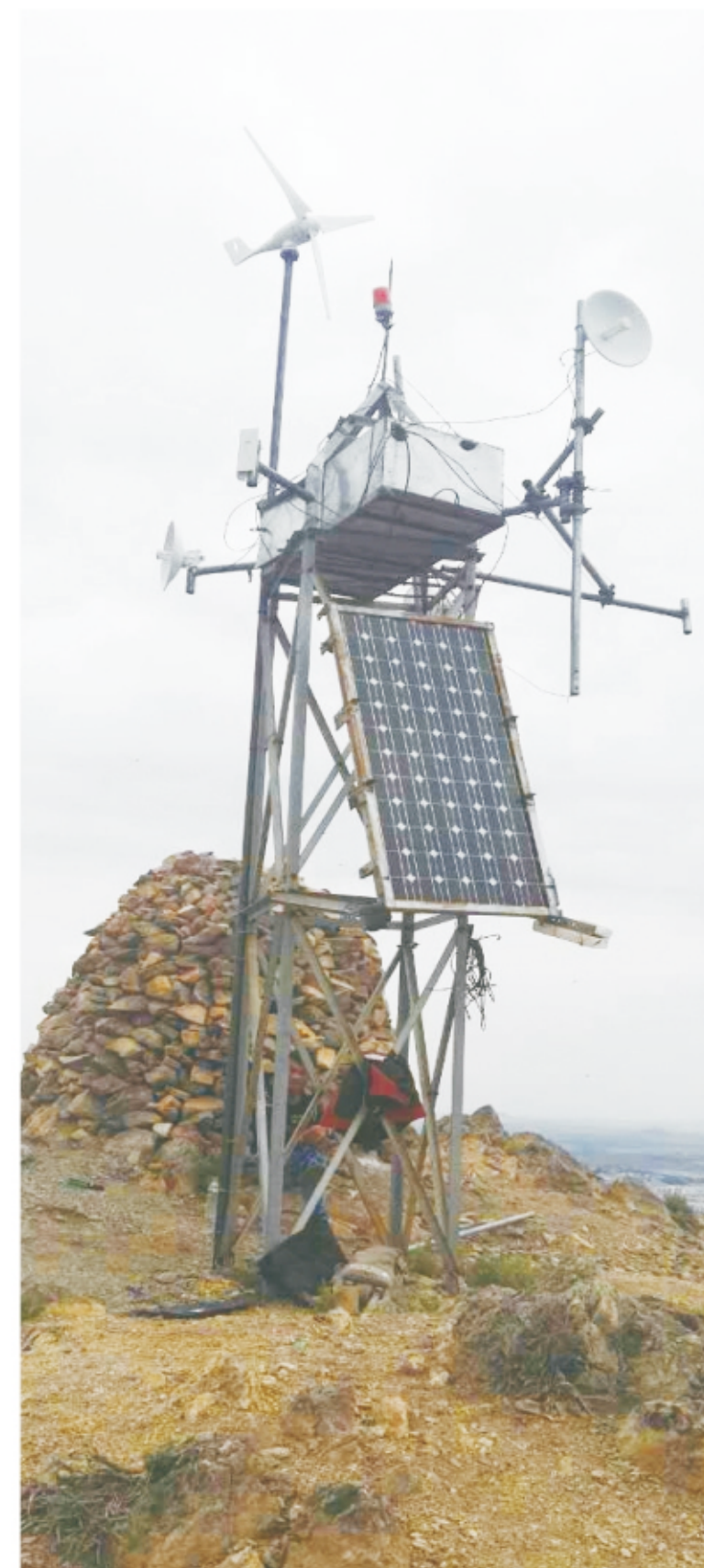
内蒙古赤峰发射塔项目-风光互补通讯基站
