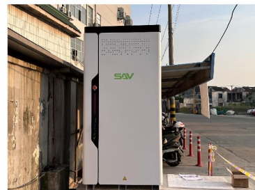
无锡市200KWh项目
