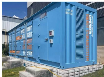
湘潭市2.25MWh项目
